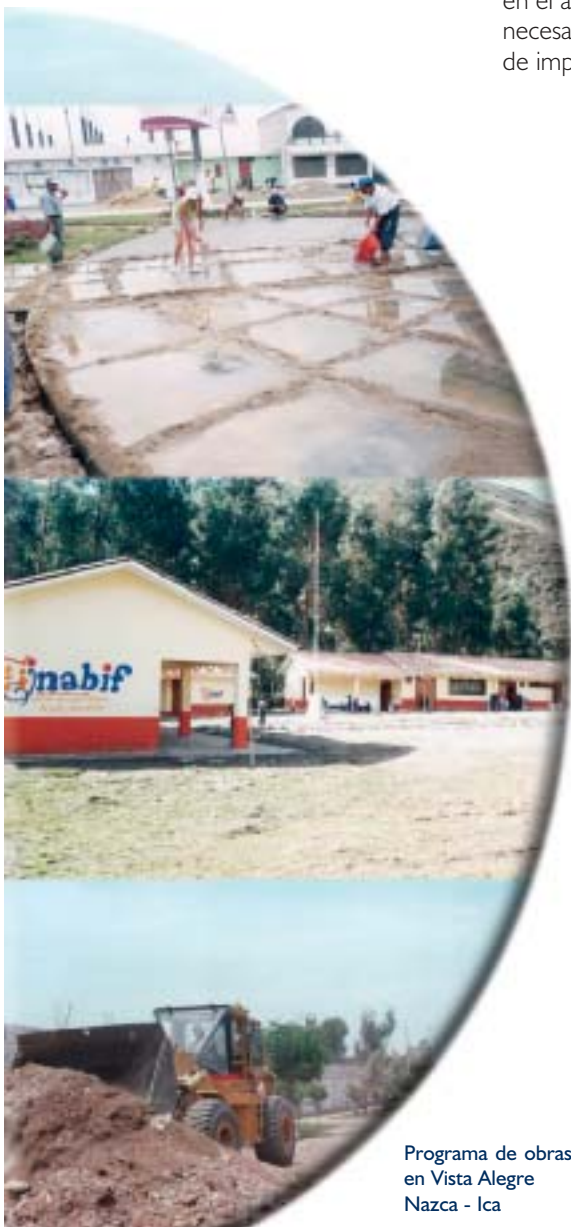
Trabajos de modernización de la Plaza de Armas de Víctor Larco Trujillo - La Libertad
